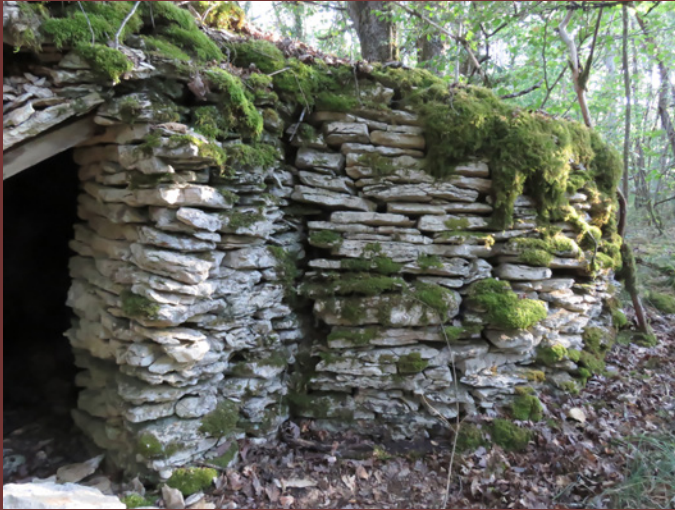
Cadole n° 19 à Gyé-sur-Seine, à noter les maçonneries de soutènement désolidarisées ou sans harpage. Il s'agit par ailleurs d'une cadole en grand risque d'effondrement à cause de la faiblesse du linteau
