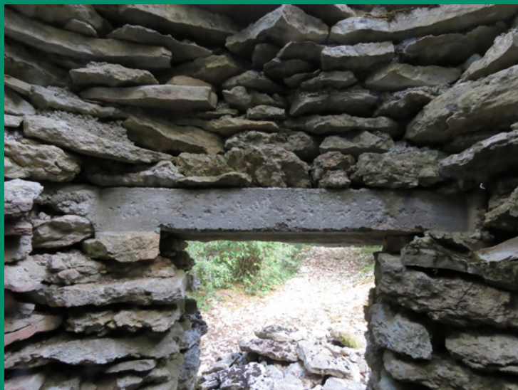
Cadole n° 89 à Courteron. Vue de l'intérieur : linteau repris en béton
