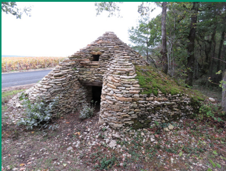
Cadole n° 150 à Neuville-sur-Seine. Ouvrage remonté, à remarquer le développement des mousses côté bois.
