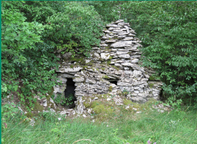
Cadole n°94 (C10) à Courteron, en risque d'effondrement
