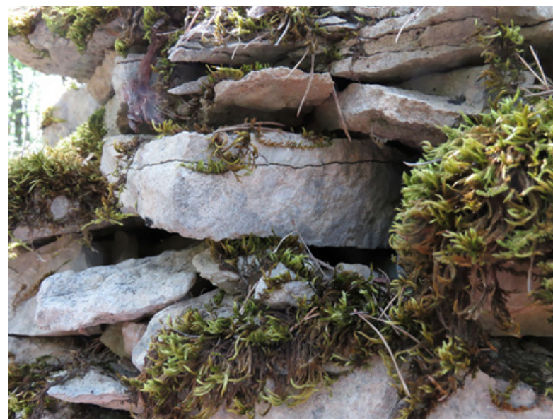
Détail du développement des mousses sur les pierres. A noter le délitement
