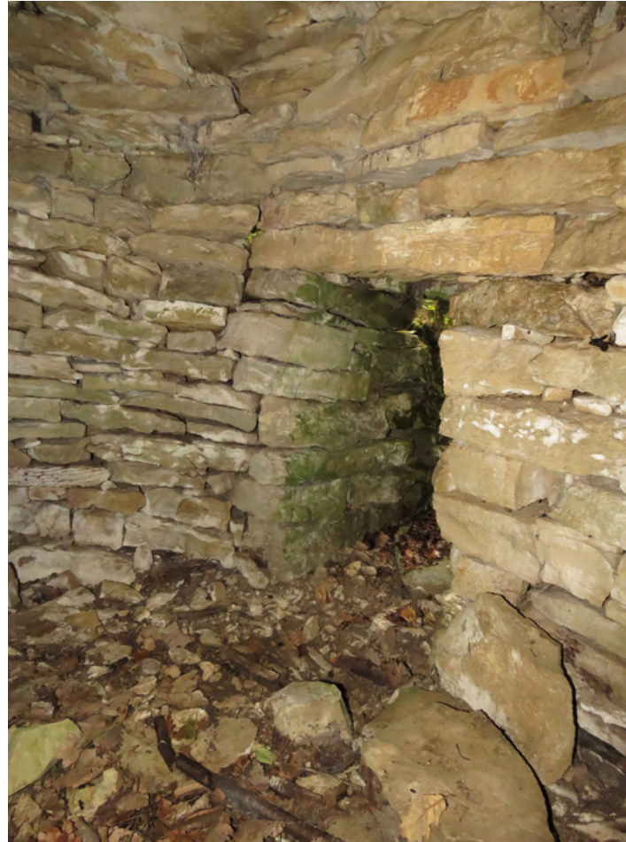
Cadole n° 120 à Gyé-sur-Seine, à noter le coup de sabre au droit du piédroit
