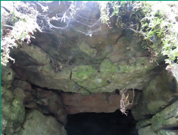
Cadole n°120 à Gyé-sur-Seine. A remarquer la fissure sur la pierre de linteau
