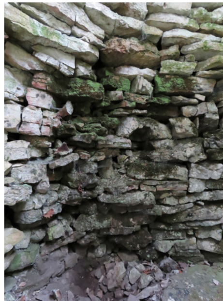
Cadole n°123 à Gyé-sur-Seine. Plusieurs désordres sont à remarquer: noircissement, fragmentation, colonisation biologique... effet des feux et de l'humidité
