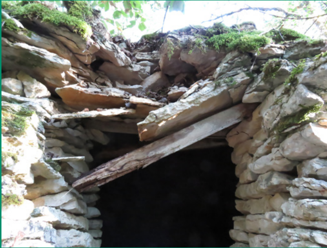
Cadole n°19 à Gyé-sur-Seine, cas de rupture d'un linteau en pierre. A noter un deuxième en bois possiblement posé en renfort
